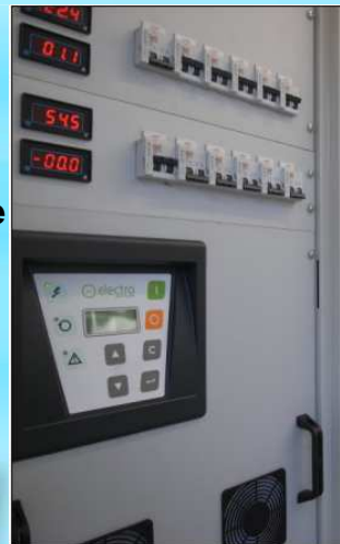
Cabina di trasformazione da alta a media tensione
