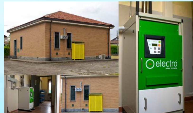
Stazione di commutazione linea ADSL
